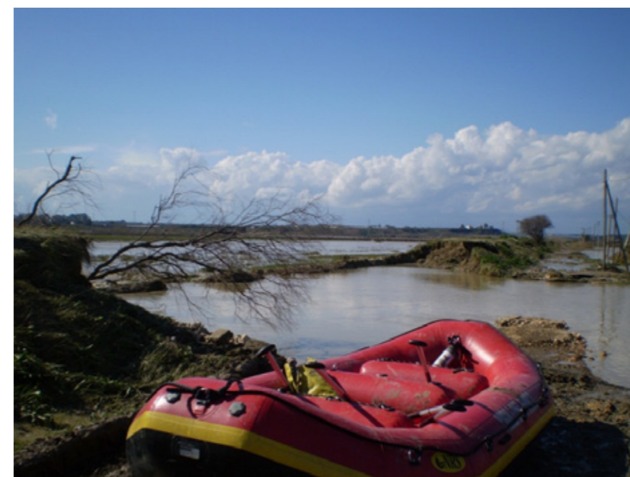
Figura 4.13. Rottura arginale in sponda sinistra del Fiume Bradano immediatamente a monte dell'attraversamento della SS106.
