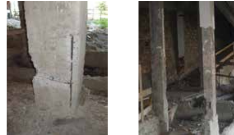
Figura 14: Particolare pilastri con assenza di copriferro
