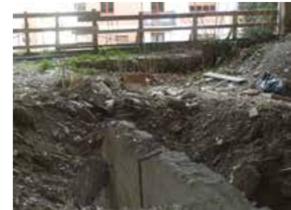
Figura 21: Immagine della platea con individuazione di fenomeni patologici di degrado
