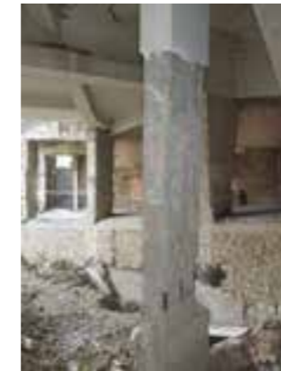
Figura 20: Immagine della platea con individuazione di fenomeni patologici di degrado
