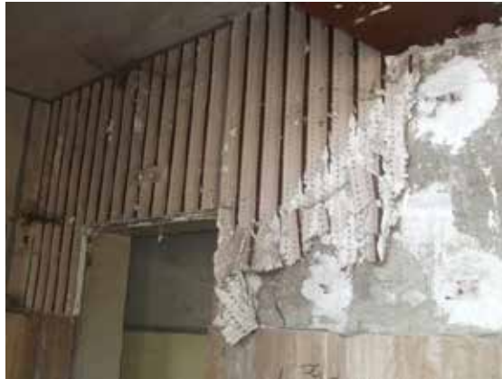
Figura 23: Immagine della galleria con individuazione di fenomeni patologici di degrado
