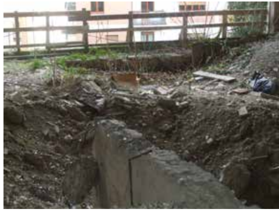
Figura 21: Immagine della platea con individuazione di fenomeni patologici di degrado
