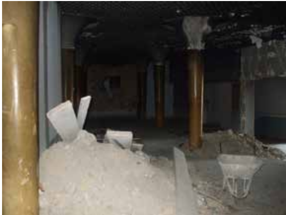
Figura 22: Immagine dell'atrio con individuazione di fenomeni patologici di degrado
