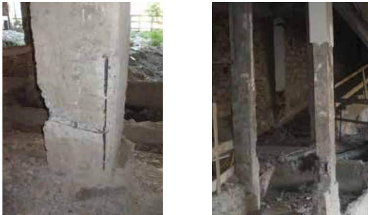
Figura 14: Particolare pilastri con assenza di copriferro
