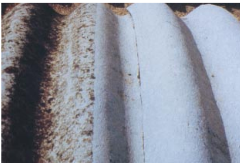
Esempio di trattamento incapsulante per la bonifica di coperture in cemento amianto
