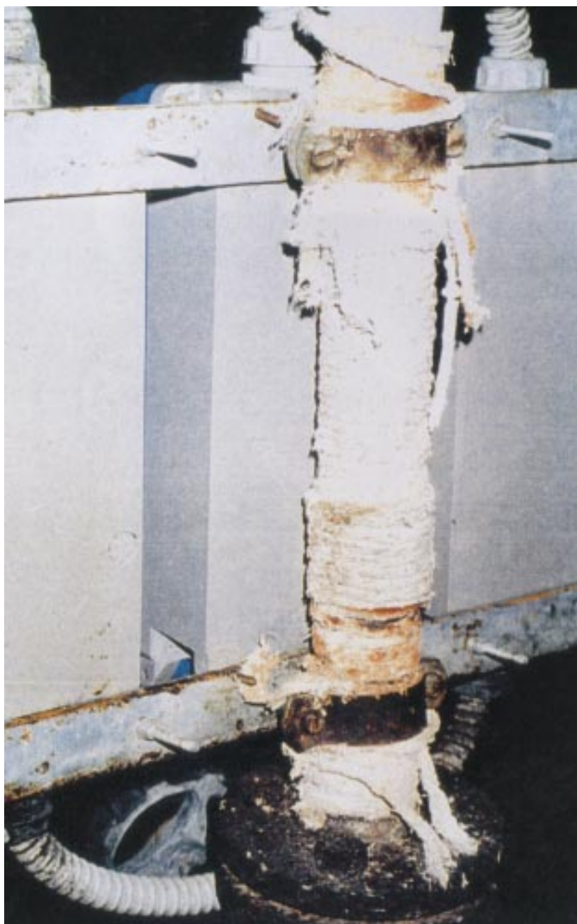
Corda in amianto (crisotico) utilizzata come coibente termico
