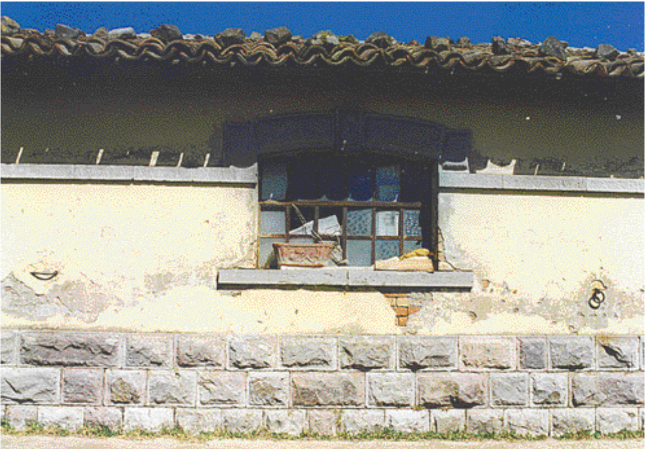
Particolare del fronte laterale della stalla della masseria Lago del Monaco caratterizzato dal forte sporto di gronda della copertura, dalla fascia lapidea all'altezza delle finestre e dalla zoccolatura bugnata. Le finestre presentano l'architrave a bugna, la lunga soglia lapidea e l'infisso in ferro a grata.
