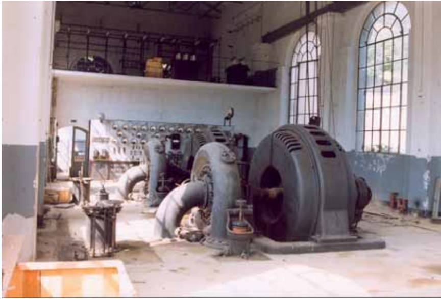
Fig. 11. Sala macchine della centrale. (Archivio Privato A. Nardiello)
