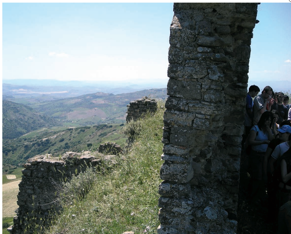
Figura 11 Panoramica del fosso del Varvaro; da notare che il muro perimetrale, in questa zona, è sostenuto da contrafforti ortogonali, costruiti successivamente a difesa della erosione calanchiva, che impedivano lo scalzamento al piede delle fondazioni
