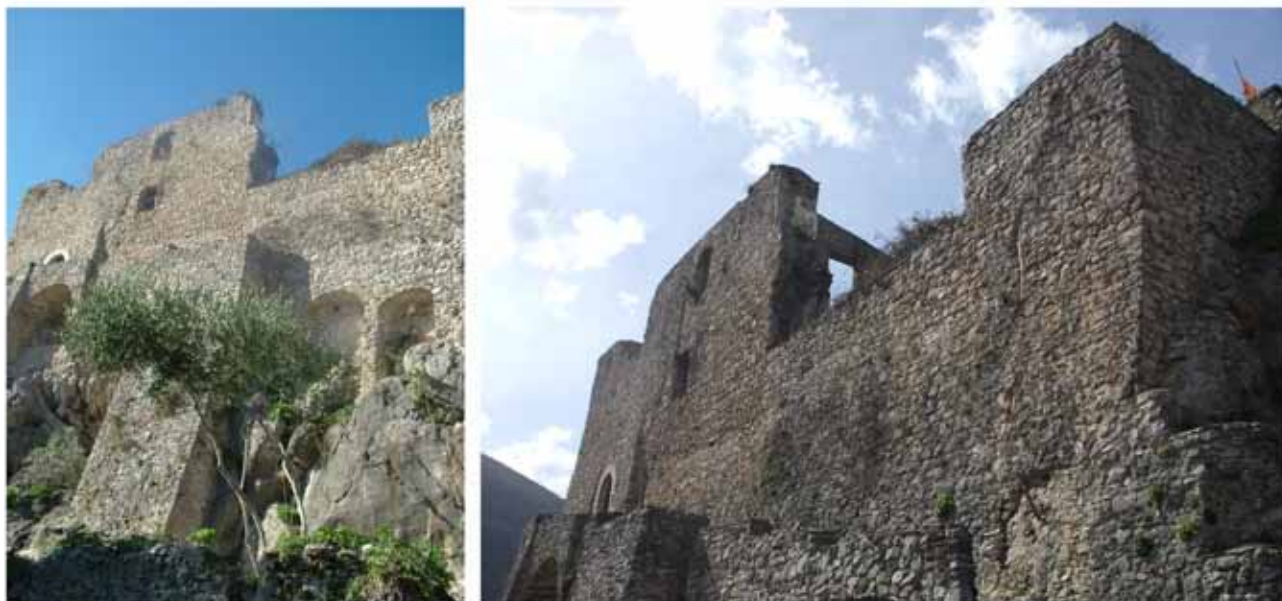
Figura 4.11 Vista del rudere con paramenti murari e orizzontamenti crollati
