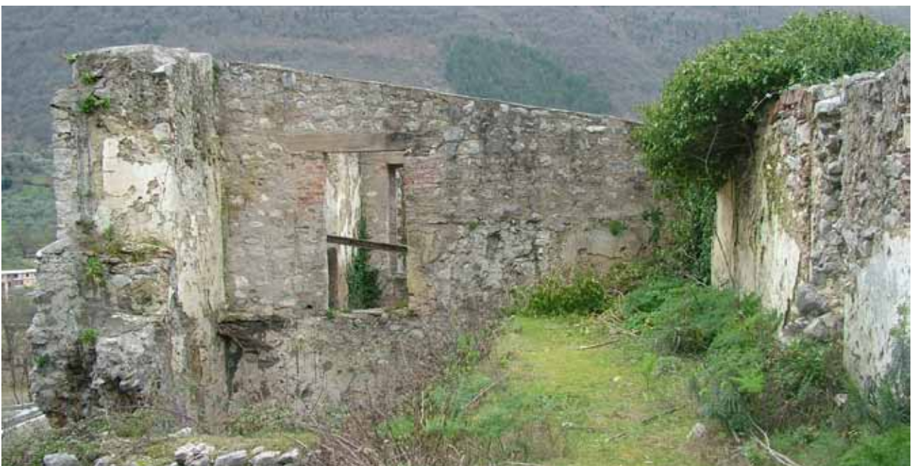
Figura 4.11 Vista del rudere con paramenti murari e orizzontamenti crollati
