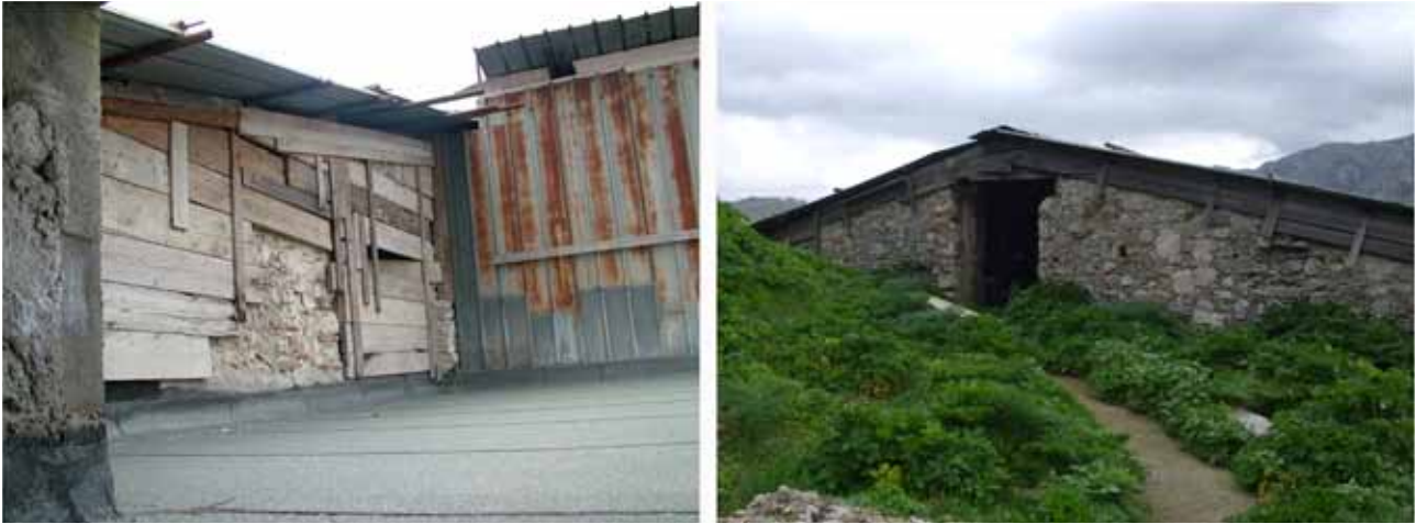
Figure 7.7-7.8 Copertura fatiscente del volume della Filanda
