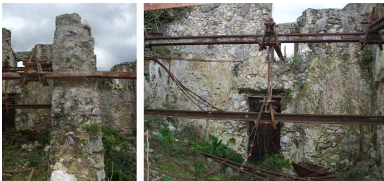
Figure 7.5-7.6 I principali dissesti del Rudere del Castello
