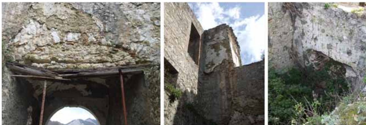
Figure 8.3-8.4-8.5 Strutture murarie del Castello interessate da crolli, indebolimento e cedimenti
