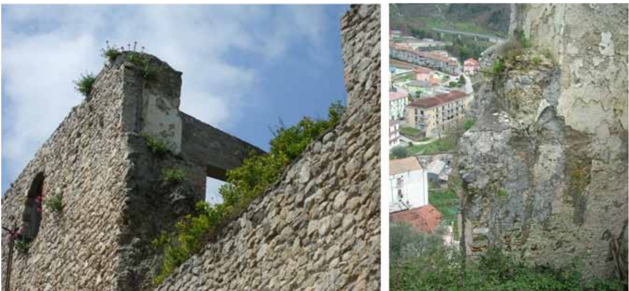
Figure 8.1-8.2 Strutture murarie del Castello interessate da crolli, indebolimento e cedimenti
