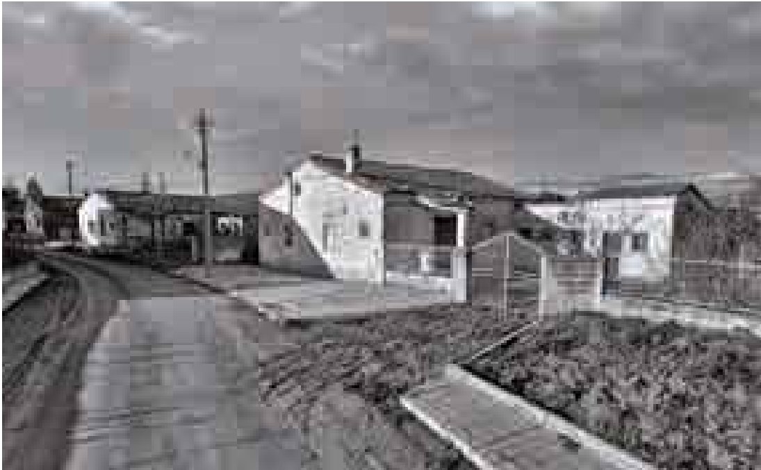
Fig.4.36 Case coloniche del tipo "C con stalla adiacente" del borgo Taccone in Agro di Irsina, Matera. La maggior parte delle abitazioni oggi risultano abbandonate e in una condizione di grande degrado.
